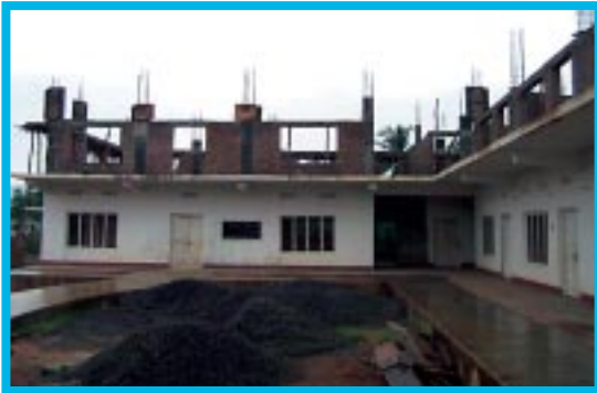
Die Aufstockung der Gebäude ist in vollem Gange. Anfang September soll das Dach aufgesetzt werden.
